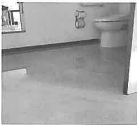
浸水時の部屋の状態 十二センチの浸水
